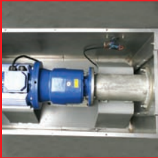
Transmisión con motorreductor
