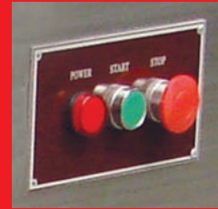
Seguridad eléctrica: - Parada de Emergencia - Relay térmico
