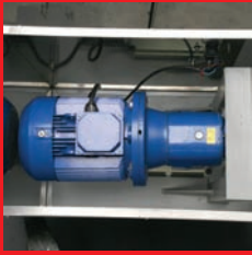
Transmisión con motorreductor
